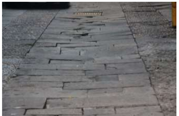
Estado del enlosado en la calle Cortaduría
